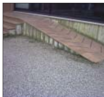
A1-9 Rampa con pendenza eccessiva, priva di parapetto e variazione cromatica
