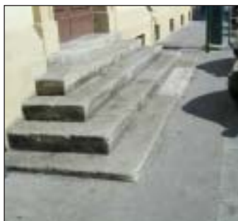
A1-26 Necessità di inserimento di rampa
