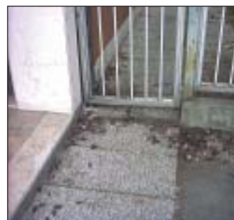
A1-5 Pavimentazione sconnessa in corrispondenza dell'accesso
