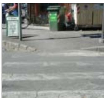
B1-2 Percorso pedonale con pendenza trasversale maggiore dell'1%.
