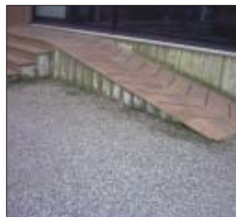
A1-27 Rampa con pendenza eccessiva, priva di parapetto e variazione cromatica
