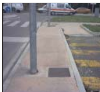
B1-1 Percorso pedonale con larghezza minima di 90 cm. Il palo dell'illuminazione riduce il passaggio e rende impossibile l'utilizzo da parte di persone non deambulanti
