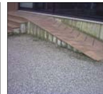
B1-9 Rampa con pendenza eccessiva, priva di parapetto e variazione cromatica
