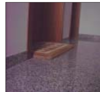
A1-6 Zerbino di spessore elevato, che costituisce ostacolo
